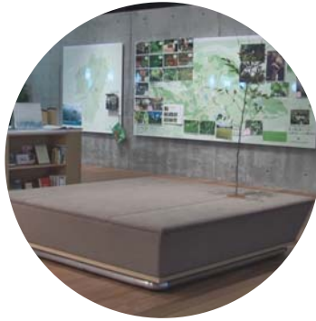
■ 벤치하부에 설치한 파이프스피커
