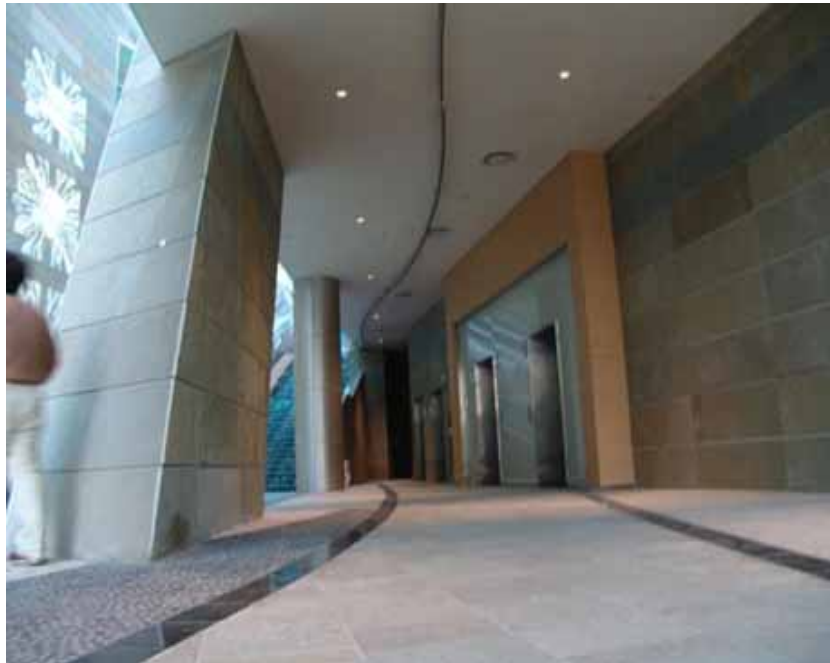
▶ [스타시티 연결통로]곡선처리를 한 천정 부착형 파이프 스피커
